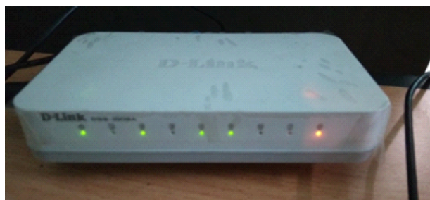
Gambar 1. Perangkat keras switch hub di perpustakaan Pusrisikan lantai 2
