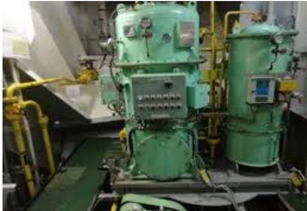
Gambar 55. Oil Water Separator di Kamar Mesin.
