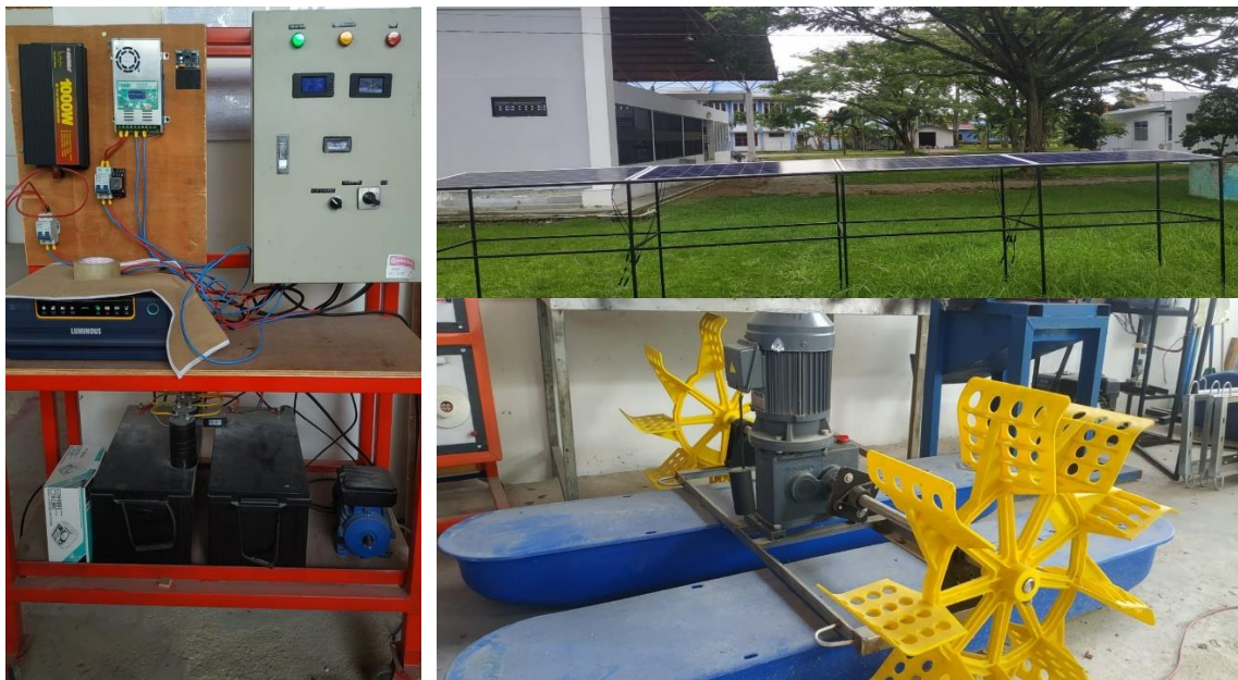
Gambar 10. Panel ATS, Modul Surya dan Motor Kincir Air.
