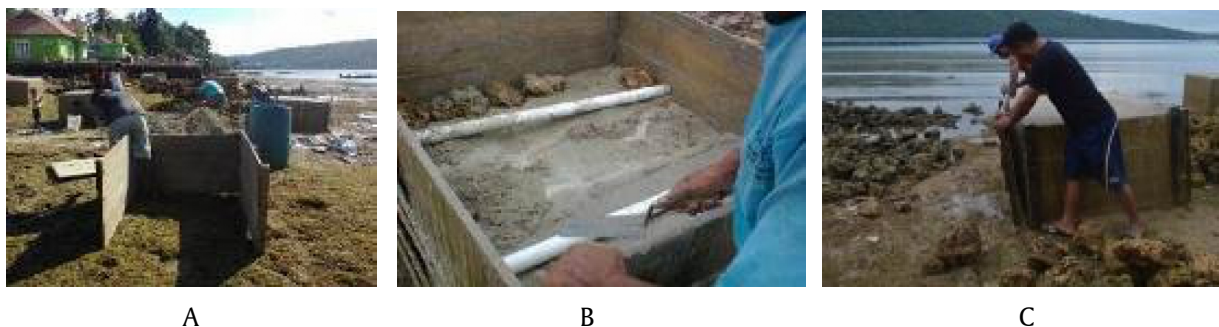
Gambar 1. Pembuatan cetakan (A), pengecoran jangkar dan pemasangan lubang pengait (B), pelepasan cetakan (C)
