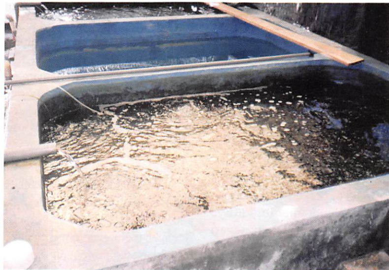
Gambar 2. Bak dengan filter pasir ( sand filter )
