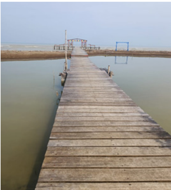
Gambar 8. Jembatan akses menuju Pantai Glagah Wangi di lokasi penelitian tergenang.
