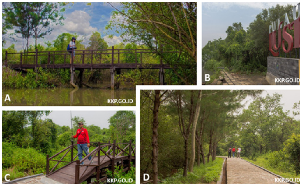
Gambar 6. Kondisi eksisting bangunan infrastruktur di Pulau Lusi. Jembatan Kayu (A & C). Monumen Ikonik Pulau Lusi (B). Bangunan jalan semen dan batu dan selokan jalan (D). Sumber: KKP (2018)..
