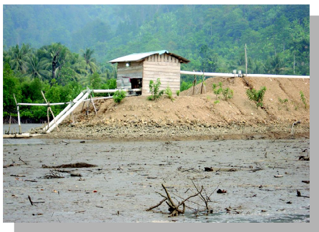
Gambar 5. Saluran tipe tertutup yaitu pipa untuk menyalurkan air yang dipompa dari laut yang dasar perairannya berlumpur
