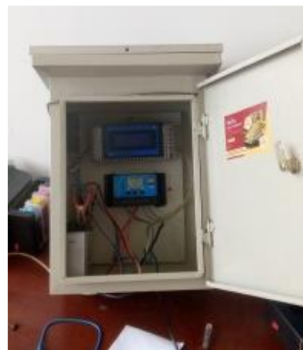
Gambar 3. Bagian Dalam Kotak Panel
